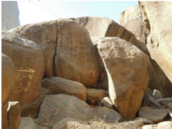
57. Crack (V2) WP70
